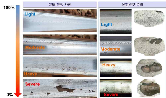
그림 2. 레일손상 진행도 Figure 2. Rail damage progression
