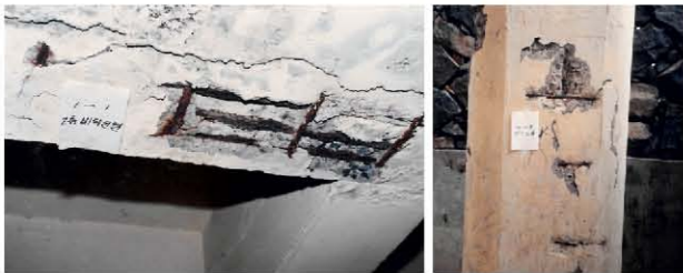
2층 바닥 균열부분과 1층 기둥 피복탈락 부분
