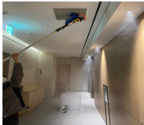
④ Check whether the exhaust fan fan is working
