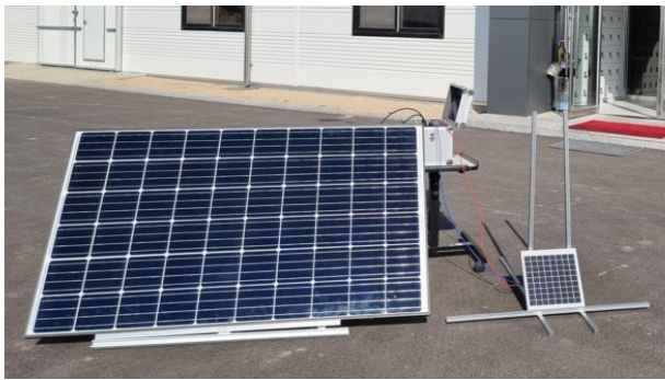
그림 11. 태양광 패널 효율 측정1
