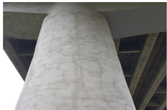
(d) Re-damage in Pier
