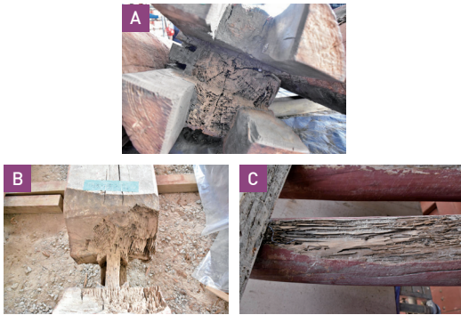
그림 1 중요 정전 서월랑의 흰개미 피해 A: 기둥 상부 결구부의 흰개미 피해, B: 대들보 결구부의 흰개미 피해, C: 서까래 상면의 흰개미 피해
