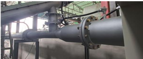
Fig. 3 Actual ejector type sludge feeding system
