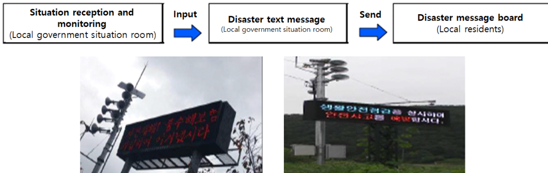
그림 8. 재해문자전광판시스템 Fig. 8. Disaster message board system
