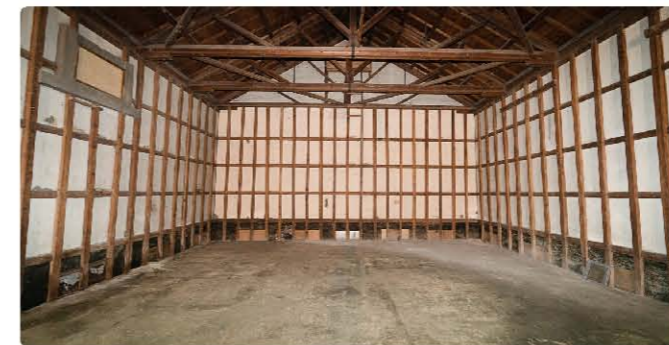
내부하부 통풍환기창 및 상부환기창
