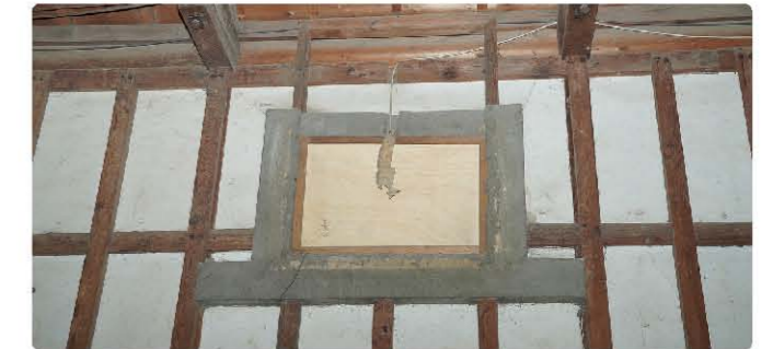
내부상부에 설치한 창
