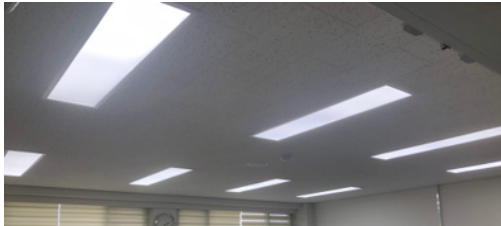
그림 16. 주변 환경 1 (LED등 모두 점등) Fig. 16. Surrounding environment 1 (all LED lights light up)
