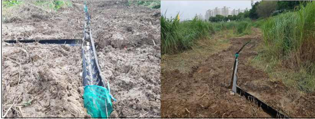
Figure 5. PE pipe linear trap
