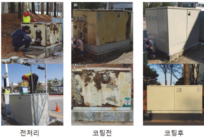
Fig. 3. 대전 유성구 노은동 일대 배전기기 실증시험.
