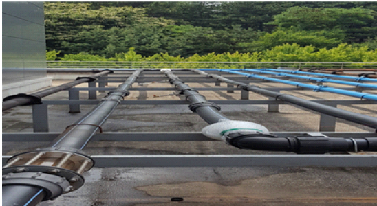
Fig. 7 PE piping Pilot Plant
