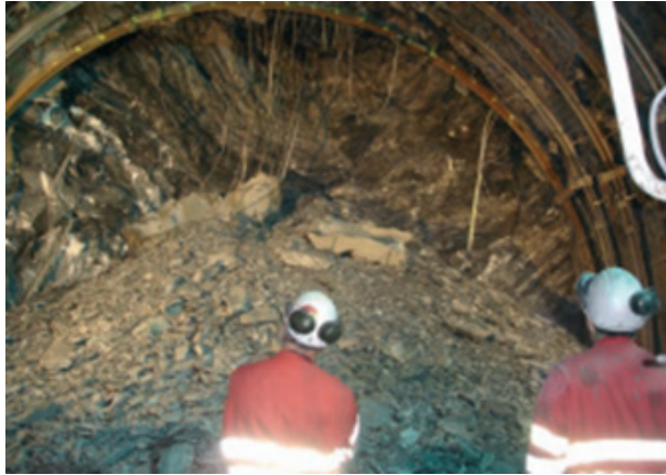
〈사진 1〉 터널링에서의 빈번한 리스크 : 막장면에서의 낙반
