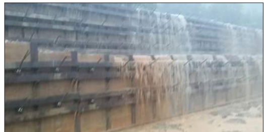
사진 2. 시공 중 지표수 처리 실패 사례
