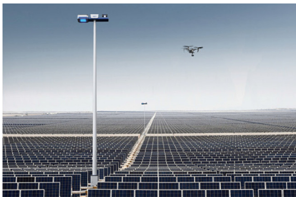
사진 1. 태양광발전장치의 설치된 모습
