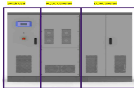
그림 6. 소형풍력발전시스템 AC/DC변환 통합장치 시스템 Fig. 6. Compact Wind Turbine System AC/DC Conversion Integrated System
