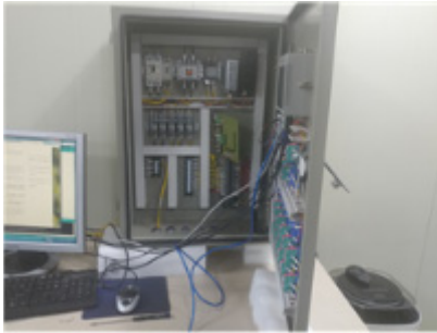
(b)관수제어시스템 내부 (b)Integrated system inside 그림 5. 통합시스템 Fig. 5 Integrated system
