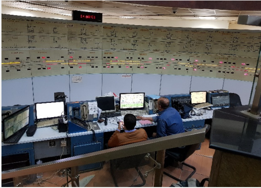
〈사진 7〉 카이로 메트로 종합사령실
