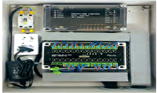
그림 7. ICT 통합 제어 시스템 Fig. 7 Integrated control system for ICT
