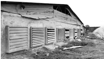
▲ 웬 셔터 파손에 의한 환기 문제 및 점등 프로그램 효과 극대화하지 못함
