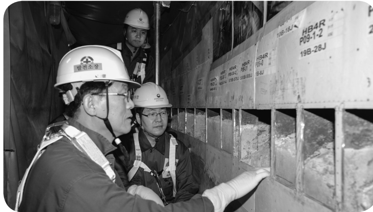
강정민 원자력안전위원회 위원장(가운데)이 한빛원전 4호기 격납건물 내부 철판 부식 및 콘크리트 공극 정비 현장을 확인하고 있다.
