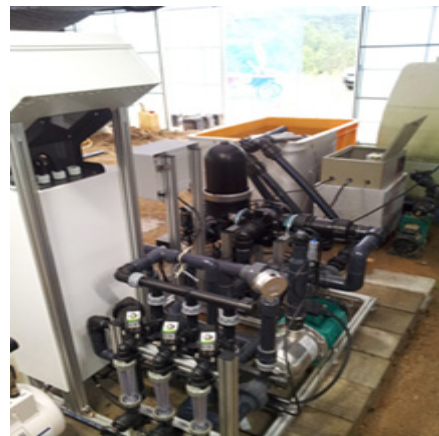
그림 4. 공조기 외부 Fig. 4. Outside air conditioner
