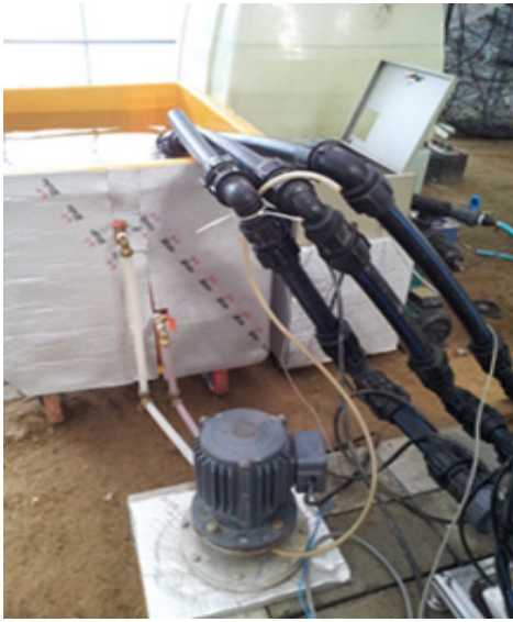
그림 5. 수조 및 배관, 산소공급기 Fig. 5. Water tank and piping, oxygen supply
