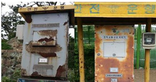
그림 4. 지방자치단체 교통신호기 관리 기능 부재로 인한 교통안전시설 기능관리 실패 사례
