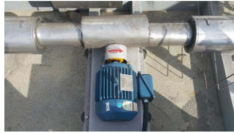
〈LCO 2 booster pump〉
