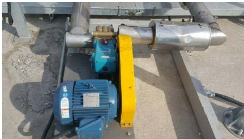
〈LCO 2 main pump〉
