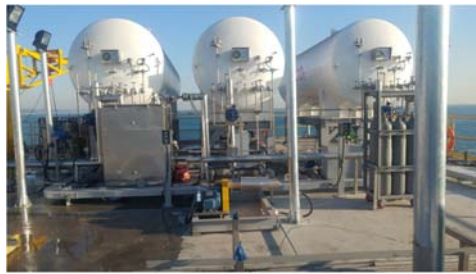
〈LCO 2 storage tank〉
