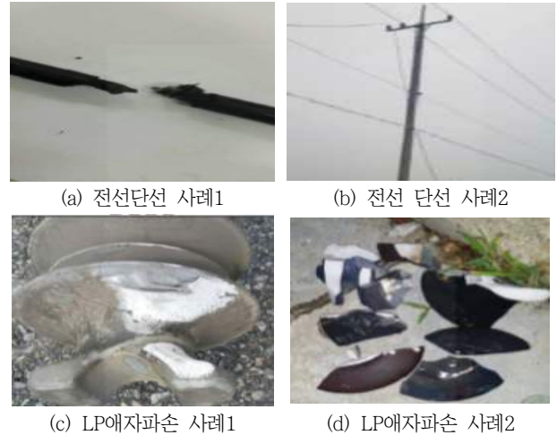
(a) 전선단선 사례1 (b) 전선 단선 사례2 (c) LP애자파손 사례1 (d) LP애자파손 사례2 그림 9 직격낙뢰에 의한 전력설비 파손사진 Fig. 9 Distribution facility breakage case caused by lighting surge
