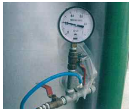
바이오가스 채취(0.2kg/cm 2 ) (Biogas extraction)
