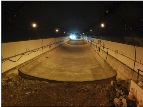
〈그림 5〉 터널바닥 용기로 인한 인버트 추가시공(Toriyasan터널)
