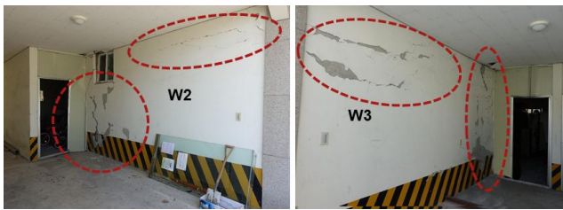
(d) Damaged walls W2 and W3
