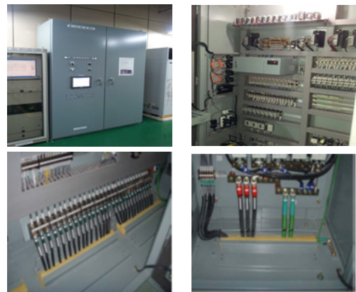
그림 3. 활선 케이블 감시장치의 외관 Fig. 3. Appearance of on-line cable monitoring system
