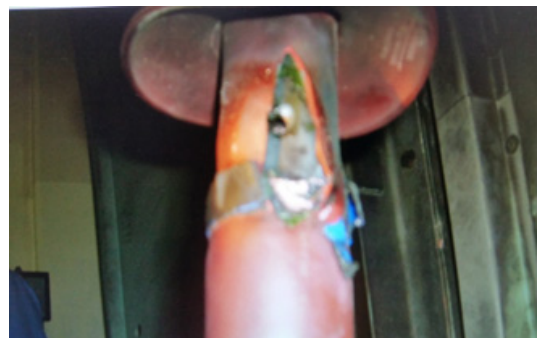
그림 5. 특이 현상 이후 절연파괴가 발생한 케이블 Fig. 5. Dielectric breakdown accident after unusual data measurement
