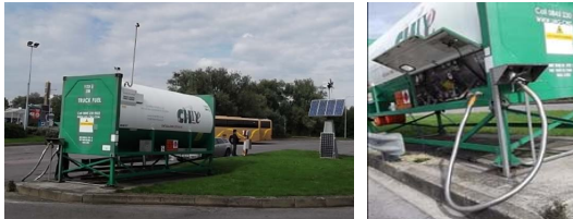
Fig. 5. Fixed LNG Fueling Station in the UK
