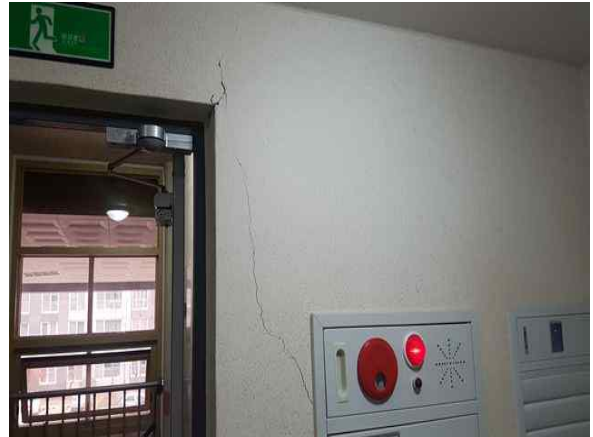
그림 1. 포항지진으로 금이 간 아파트 벽면 Figure 2. Cracked Wall of an Apartment building after Pohang Earthquake. From: http://image.hankookilbo.com/i.aspx?Guid=2f96ceb497e64773b0f9da3f48137c19&Month=201711&size=640
