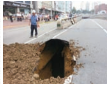
석촌지하차도 공사중 시공미흡 '14.8.5.
