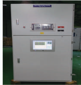
이상진단 모니터 및 계전기 설치
