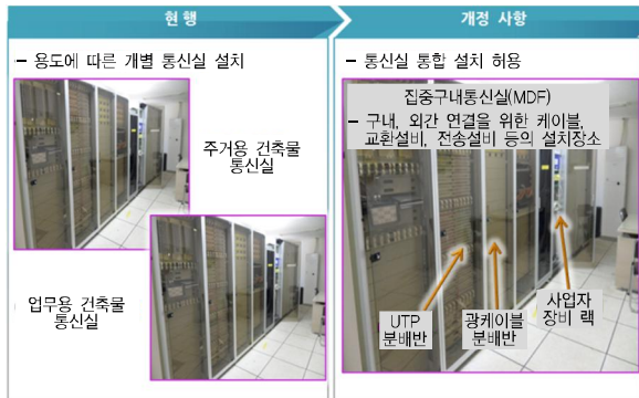
(그림 8) 집중구내통신실의 통합 설치
