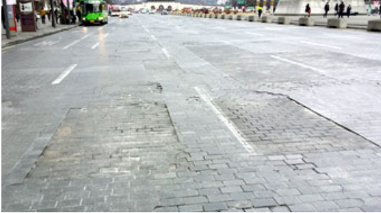
그림 7. 중차량 통행구간 파손(광화문광장 차도)
