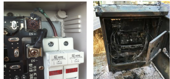
그림 2 태양광 접속함에서의 다양한 사고 사례 Fig. 2 Examples of various accidents in combine boxes
