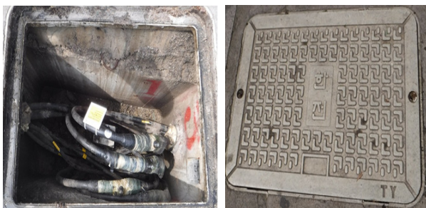
그림 3 저압 철재 지중함 내부 및 뚜껑 외부 Fig. 3 Exterior and interior of low voltage steel handhole
