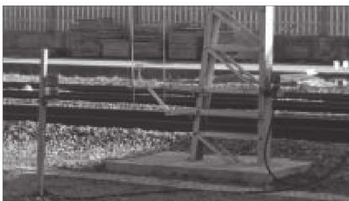
[그림 7] 당 현장 열차 접근 경보시스템 시공 현황
