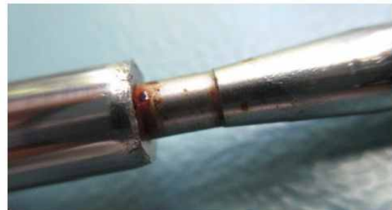
c) PRSOV Corrosion
