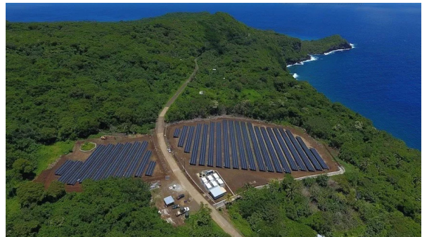
그림 9. 타우 섬에 설치된 태양광 배터리 시스템 [33]
