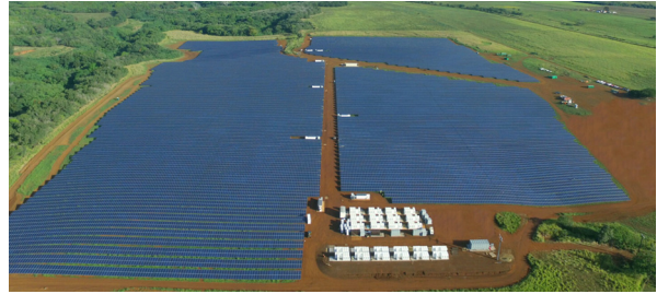
그림 8. 하와이 카우이 섬에 설치된 태양광발전소 [36]
