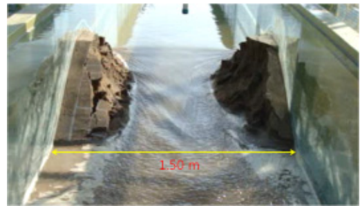
(d) Scour surface expanded by tractive force
