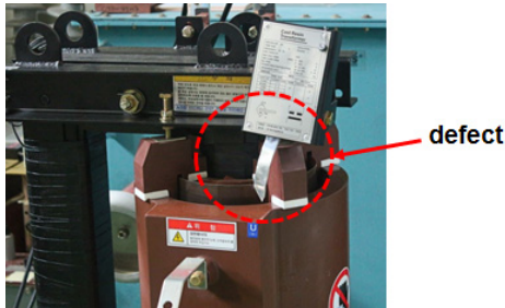
그림 1 몰드변압기의 인위적인 절연결함 Fig. 1 Artificial defect of transformer
