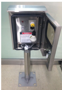
(a) 콘센트 함 (a) Outlet box
