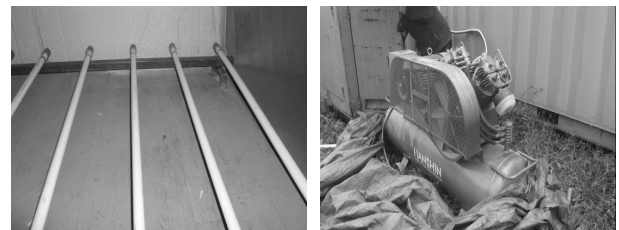
(c) Air line detail (d) Air compressor
