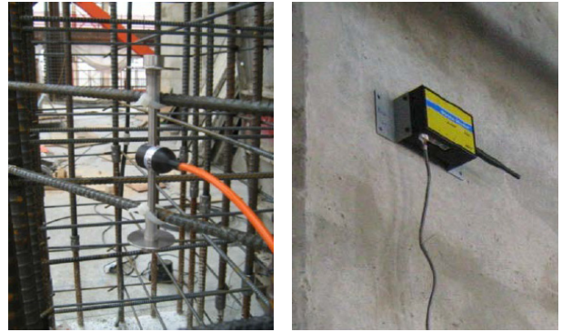
그림 5 센서 및 무선 노드 설치 사진 5)
