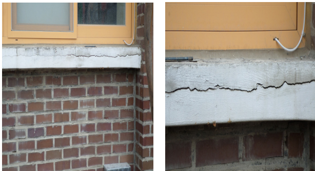
그림 1. 유지관리 중 임기응변식 불량시공(창틀하부벽 균열현황)
