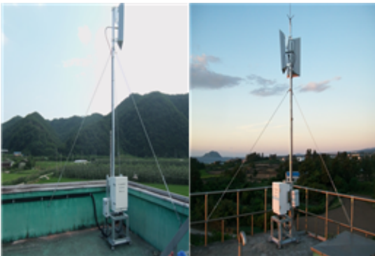
그림 5. 설치된 중계기 Fig. 5. Installed repeater system
