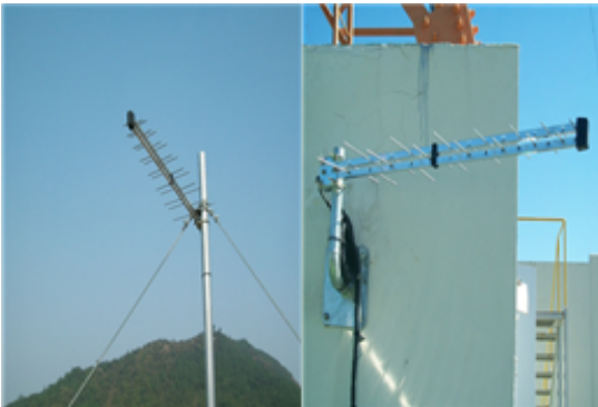
그림 4. 수신 안테나(지주, 벽면에 설치) Fig. 4. Receiving antenna(pole & wall mounted)
