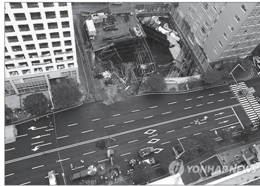
[사진 6] 도심 건축현장 가시설 붕괴사고 전경
